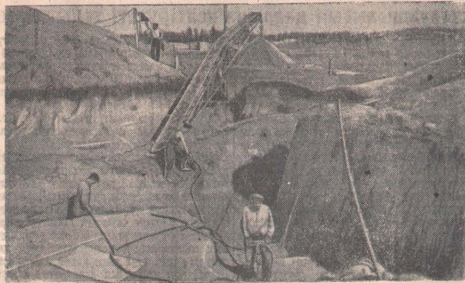
Петропавл ауданындағы Асанов МТС-де электр станциясын салуға әзірлік жүріп жатыр. Суретте: А. Гаспарян басқарған бригада электр станциясы үшін қотлован қазуда.
